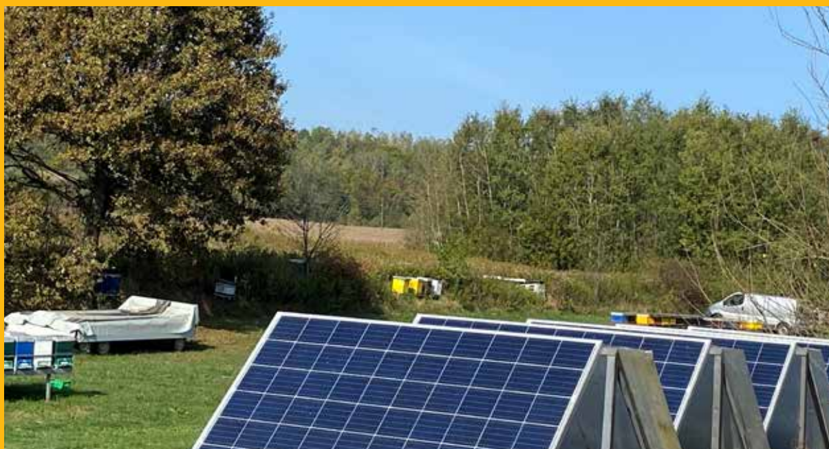
Fotonaponska elektrana od 2,5 kW
